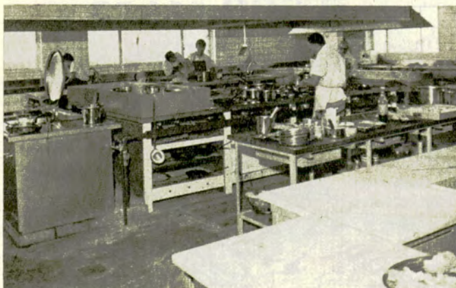
Las modernas instalaciones de la nueva cocina permiten una completa atención del comedor.
